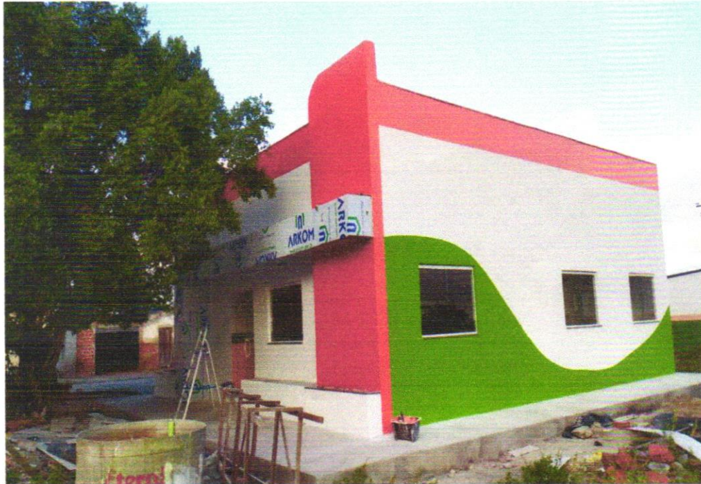
FOTO 03 - APLICAÇÃO MANUAL DE PINTURA COM TINTA LÁTEX ACRÍLICA EM PAREDES, DUAS DEMÃOS. AF_06/2014
