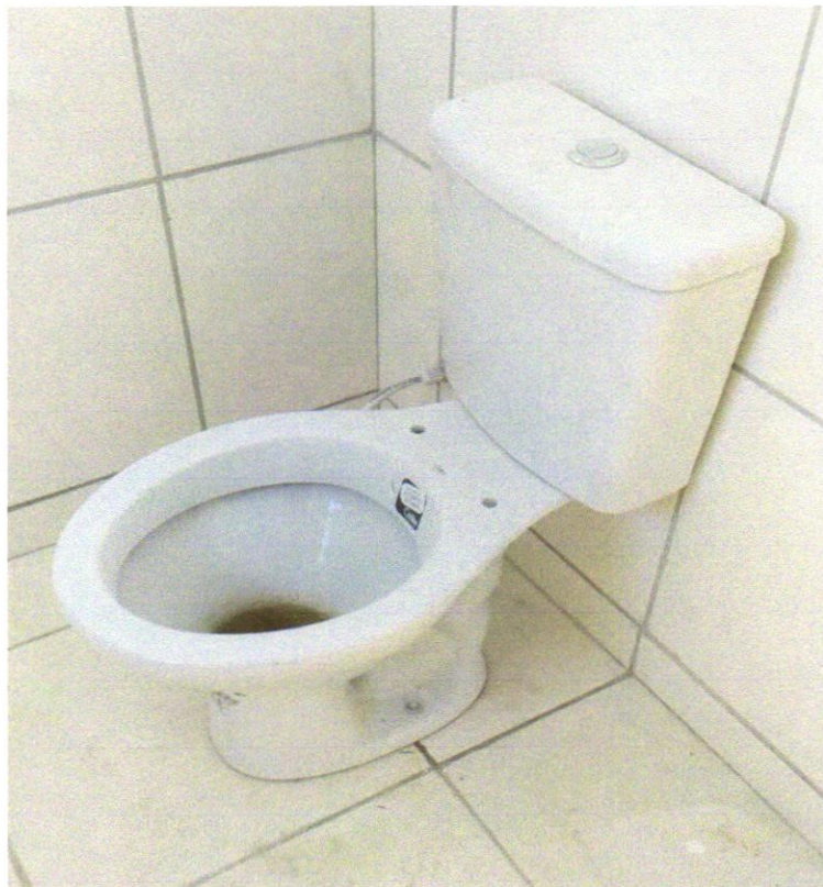
FOTO 06 – VASO SANITARIO SIFONADO CONVENCIONAL COM LOUÇA BRANCA, INCLUSO CONJUNTO DE LIGAÇÃO PARA BACIA SANITÁRIA AJUSTÁVEL - FORNECIMENTO E INSTALAÇÃO. AF_10/2016E INSTALAÇÃO AF 12/2019
