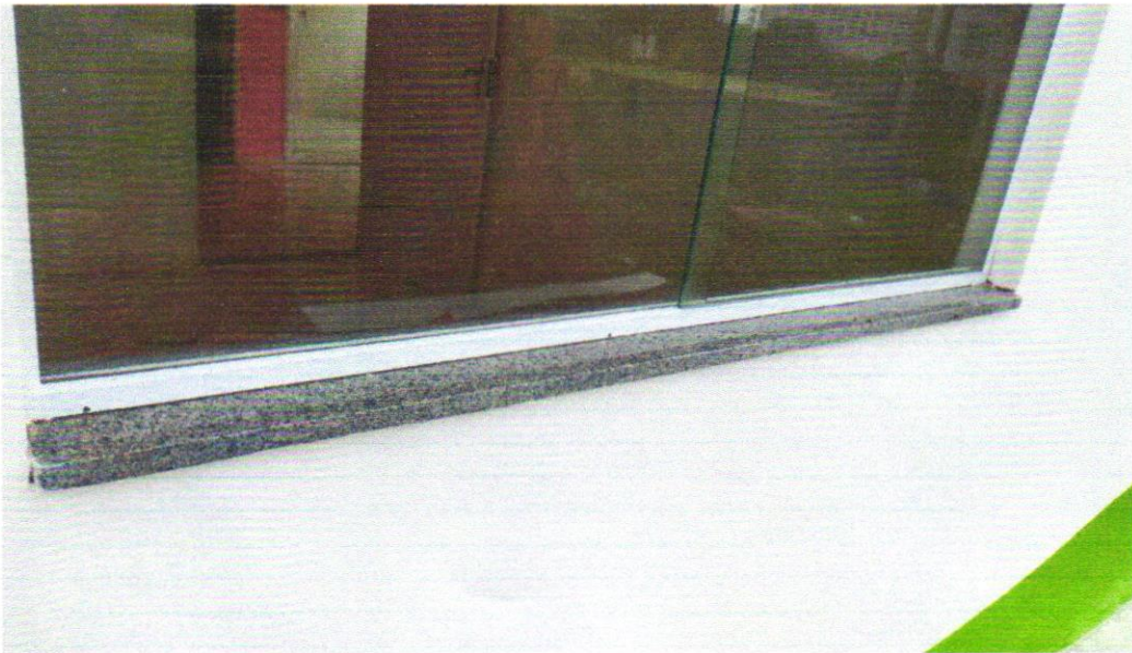
Foto 21 - PEITORIL LINEAR EM GRANITO OU MÁRMORE, L = 15CM, COMPRIMENTO DE ATÉ 2M, ASSENTADO COM ARGAMASSA 1:6 COM ADITIVO. AF_11/2020
