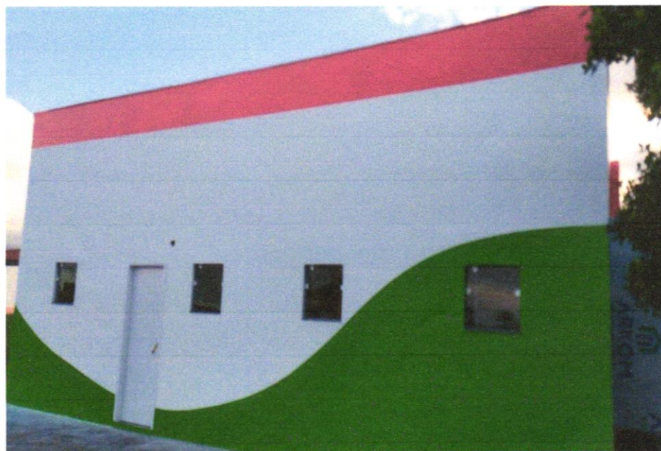
FOTO 01 – APLICAÇÃO MANUAL DE PINTURA COM TINTA LÁTEX ACRÍLICA EM PAREDES, DUAS DEMÃOS. AF_06/2014
